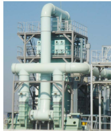
대형 WET-EP SYSTEM (FAB 외부 옥상층)
